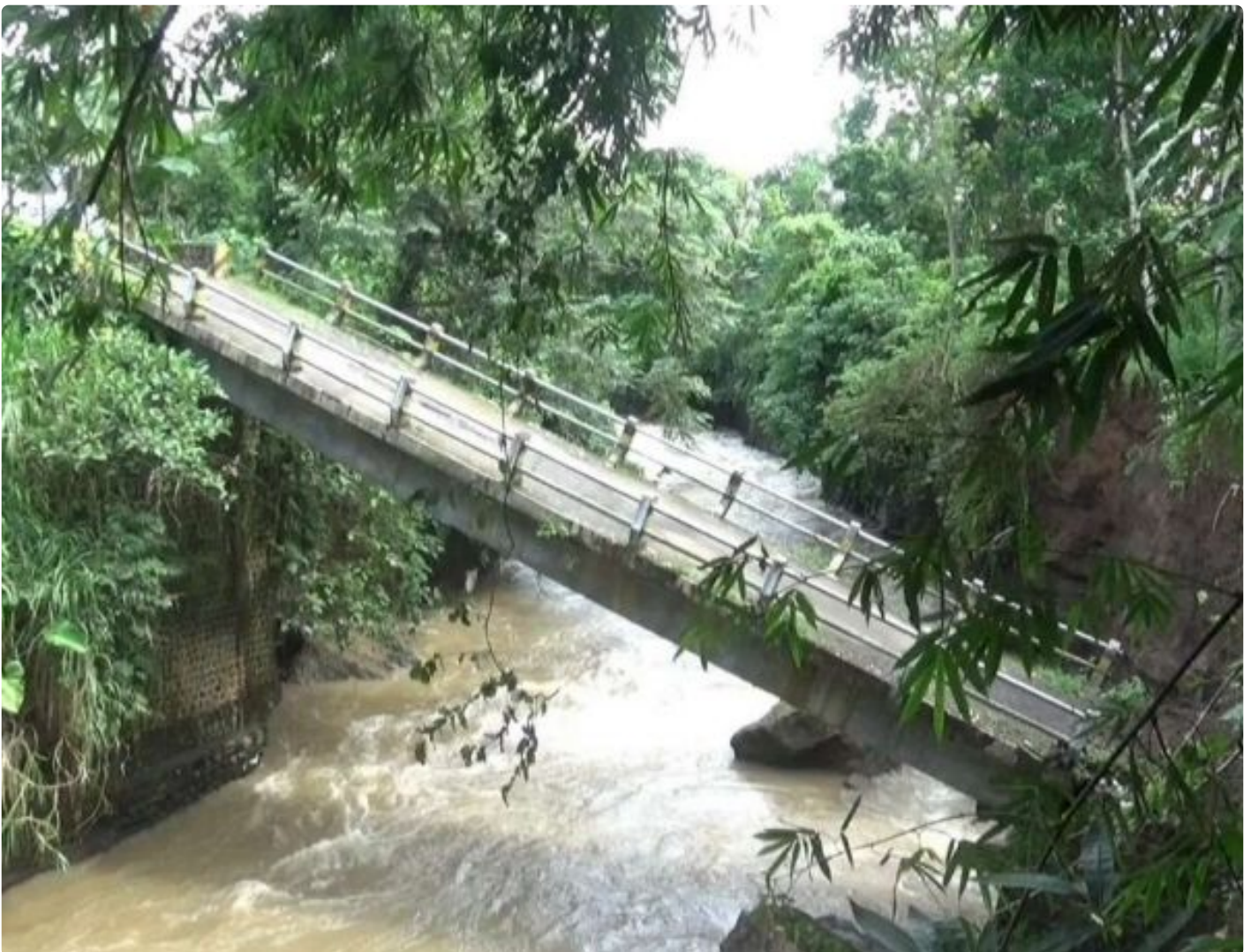
Jembatan Carangan yang menghubungkan dua desa di Glenmore ambruk
