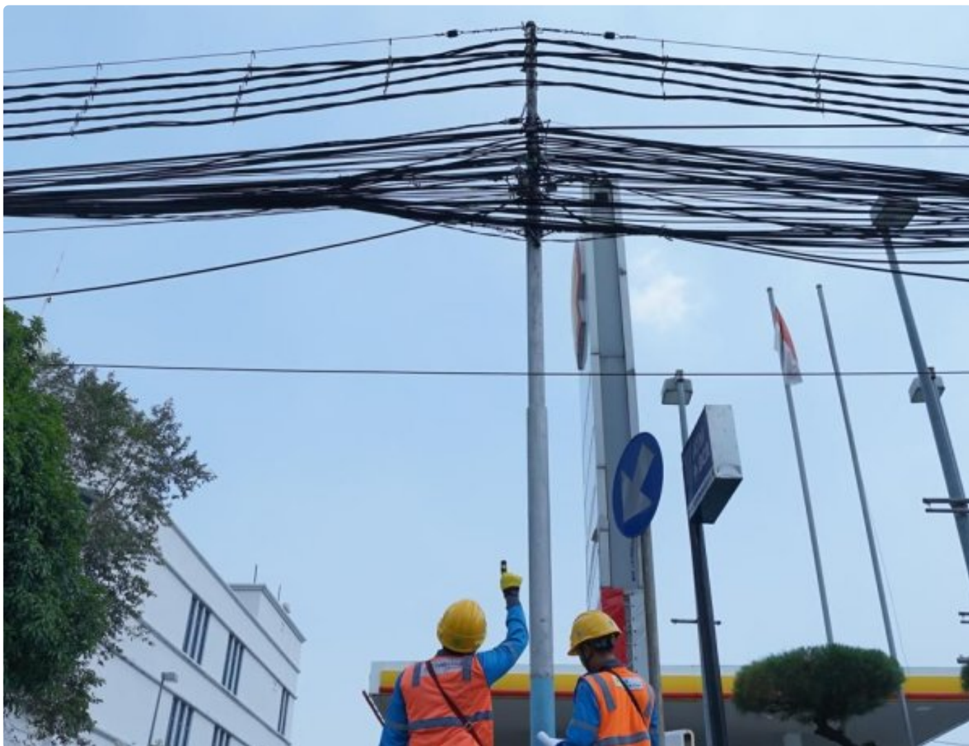
Photo: Titik Lokasi pencuri Kabel PLN
